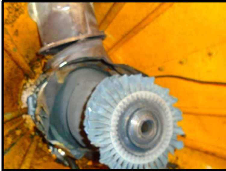
Fotografía No. 13 Daños en la rueda dos de la salida de gases, Turbina de Potencia.
